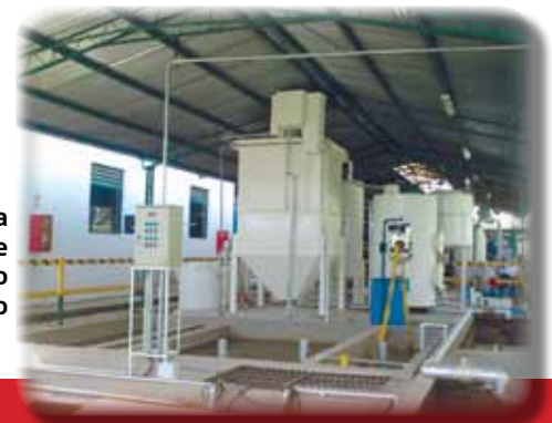
Panorámica del sistema de tratamiento físico químico
